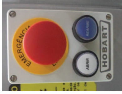
Fig. 16- Foto do Botão de parada de emergência, botão REARME e botão ABRIR.
