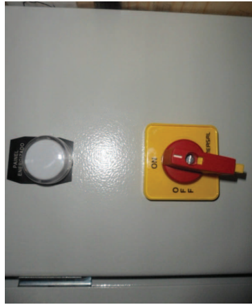
Fig. 13- Foto da chave geral na posição "on".
